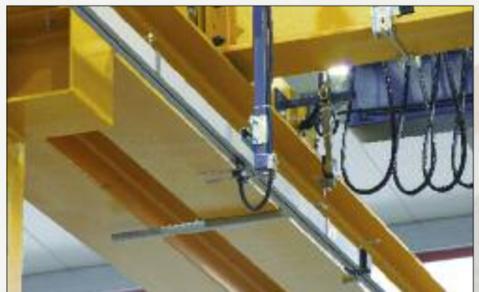
Standard-Hauptstromzuführung mit Schleifleitung
