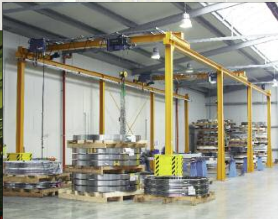
Frei stehende Portalkrananlage mit zwei 3,2 t Laufkränen
